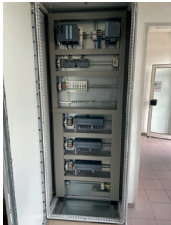
Abb. 28: Neuer zentraler SPS-Schaltschrank der Kläranlage Rospe
