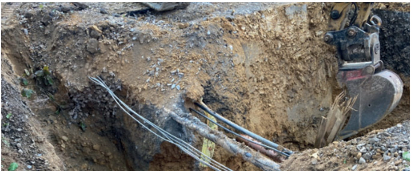
Abb. 36: Die hohe Anzahl der Versorgerleitungen und die teilweise oberflächennahe Lage erschwerten die Baumaßnahme
