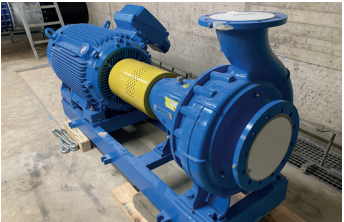
Abb. 56: Notfallpumpe Ommerborn vor der Installation
