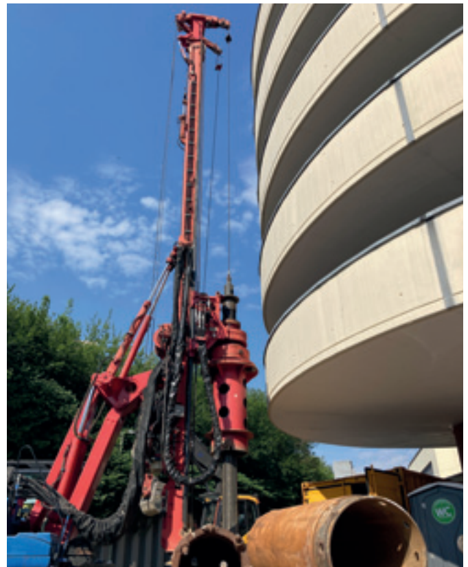
Abb. 31: Bohrung für Träger des Trägerbohlwandverbau aufgrund von Hindernissen im Untergrund bei eingeschränkten Platzverhältnissen zum Parkhaus
