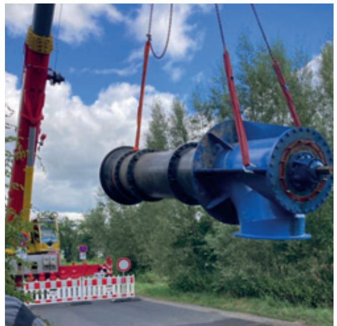
Abb. 47: Hochwasserpumpe Regenüberlaufbecken Volberg
