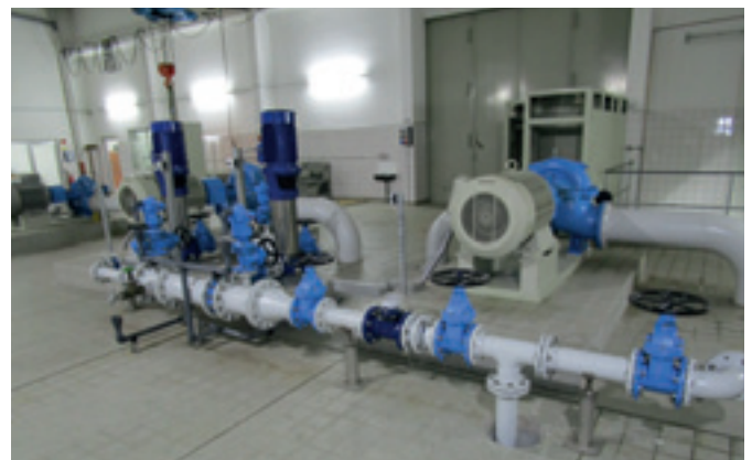
Abb. 53: Pumpwerk Hermesdorf, Pumpenhalle
