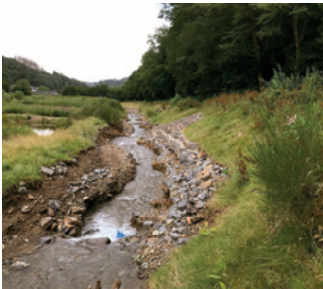
Abb. 13: Beschädigter Gewässerabschnitt am Seßmarbach
