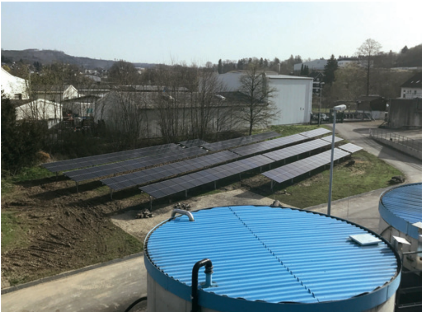
Abb. 26: Photovoltaik-Freiflächenanlage auf der Kläranlage Schönenenthal
