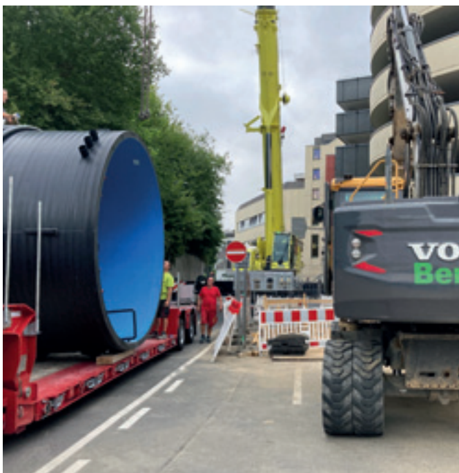
Abb. 32: Lieferung des Drosselschachtes unter Vollsperrung am Freitagabend; Absetzen nur mit Kran und Bagger zum Drehen des Schachtes möglich
