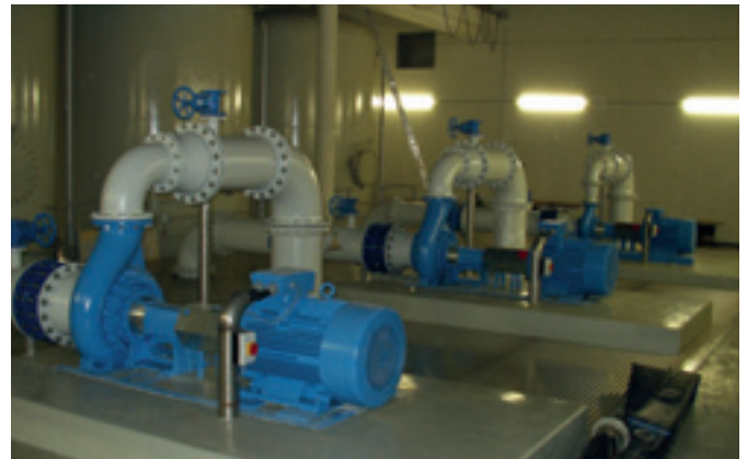
Abb. 52: Pumpwerk Alpe, Pumpenhalle
