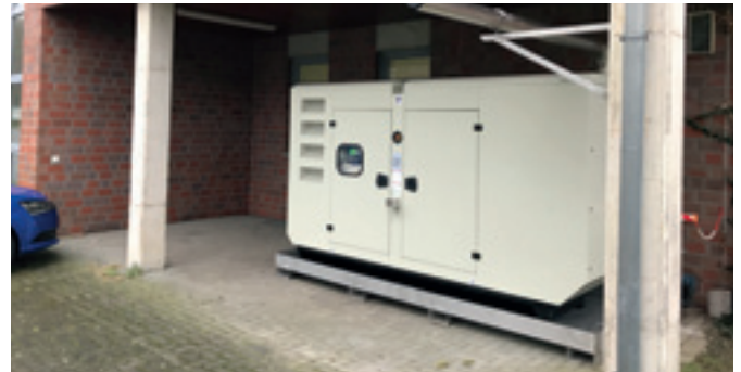
Abb. 27: Neues stationäres Notstromaggregat der Kläranlage Leimbach
