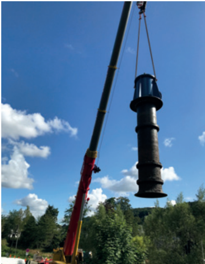
Abb. 48: Hochwasserpumpe Regenüberlaufbecken Volberg
