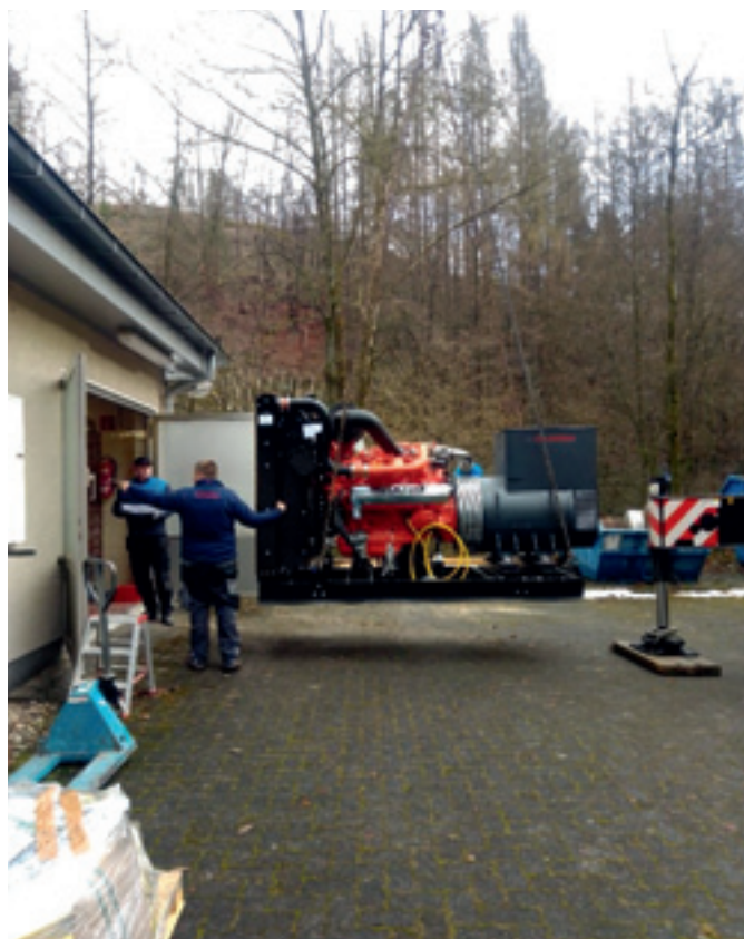
Abb. 57: Anlieferung der NEA am PW Genkel
