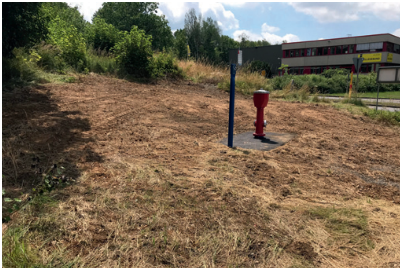
Abb. 83: ÜH Kalsbach, neuer Überflurhydrant DN 150 mm
