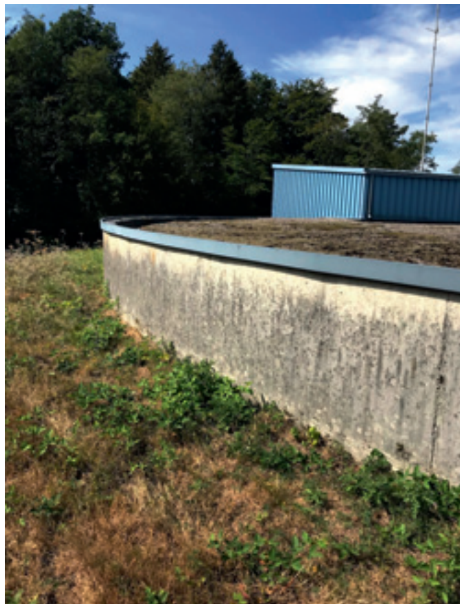
Abb. 53: alte Dachabdichtung HB Lindlar II
