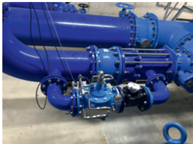
Abb. 73: Notfallpumpe Ommerborn, Mengenbegrenzungsventil DN 80 im Bypass der Pumpleitung
