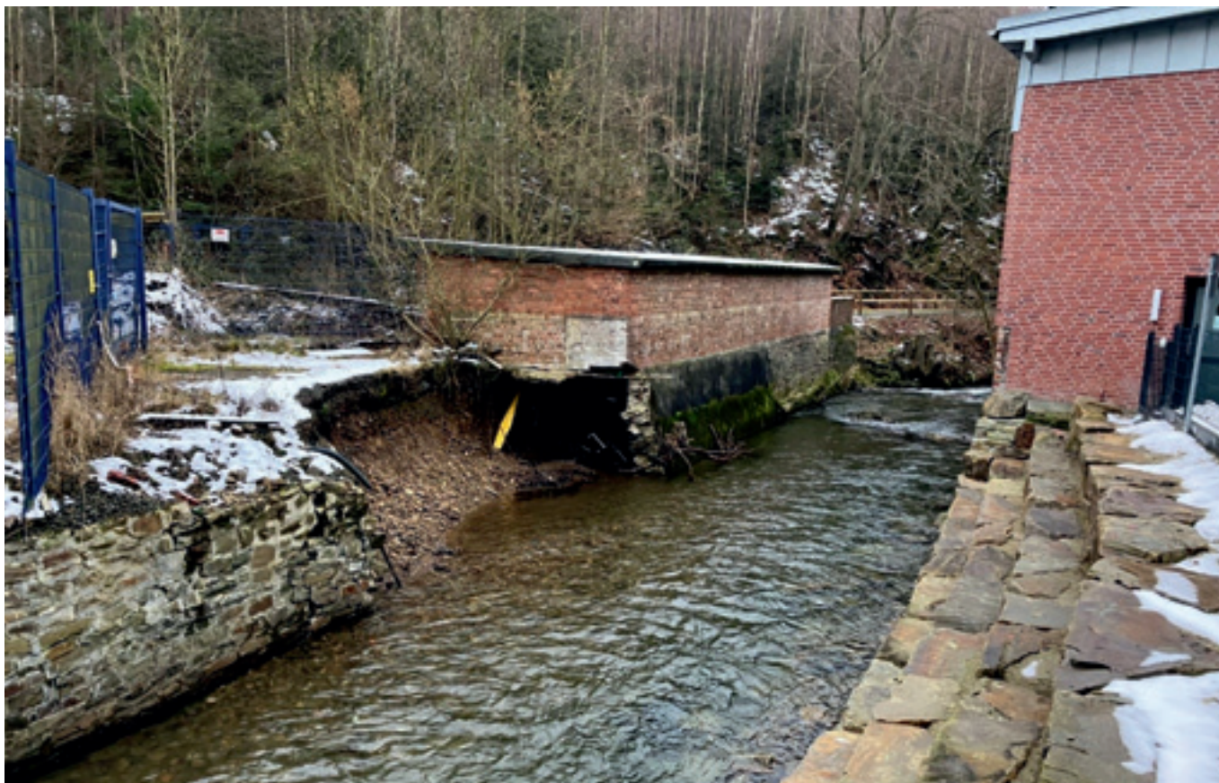
Abb. 19: Situation nach dem Hochwasser
