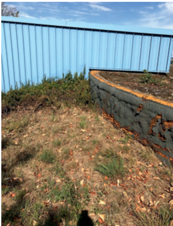
Abb. 51: alte Dachabdichtung HB Ommerborn
