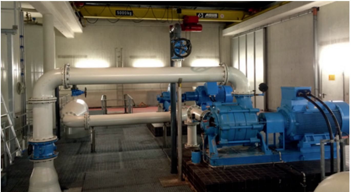
Abb. 79: PW Bredenbruch, Saugseite alt, DN 250, Stahl-Fria zinc-Beschichtung
